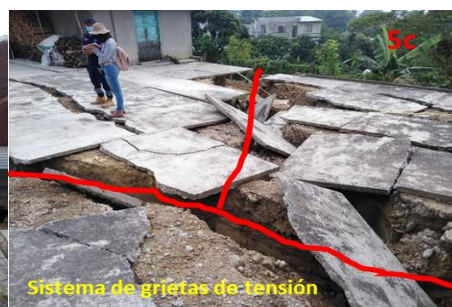
Fotografía 11. Desplazamiento genera un sistema de grietas de tensión, afectando el piso de viviendas.
