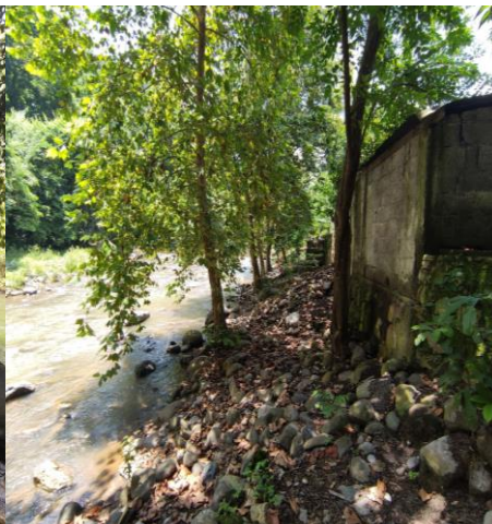
Fotografía 47. Vivienda cerca al cauce del río, provoca que en temporada de lluvias y huracanes el nivel del agua aumente de nivel afectando la infraestructura, localidad de Jalpa.
