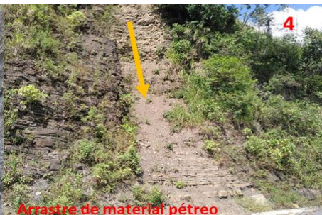
Fotografía 34. Flujos de arrastre en material de lutita-arenisca con afectación a la carretera.
