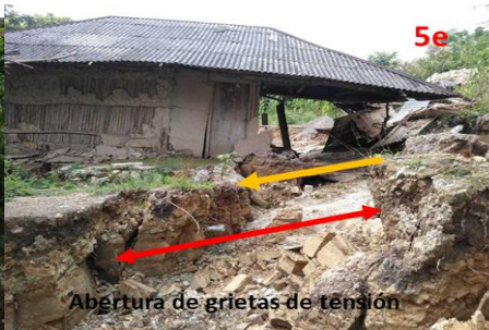
Fotografía 13. Desplazamiento con una abertura de más de 2 metros de longitud.
