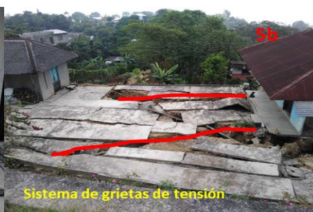
Fotografía 10. Desplazamiento generando sistema de grietas de tensión y movimiento del suelo.
