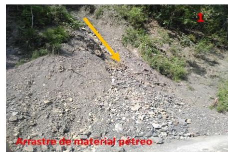
Fotografía 31. Ladera presenta flujo de arrastre con rocas de tamaño de gravilla a bloques de 0.3 m de diámetro.
