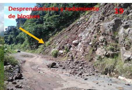
Fotografía 28. Fracturamiento en el talud genera rompimiento en la roca provocando desprendimientos y rodados de material pétreo.
