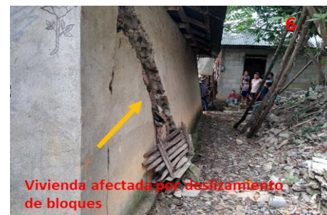
Fotografía 15. Parte de la ladera presentó movimiento causado por las obras de drenaje, provocando desplazamiento entre los bloques.
