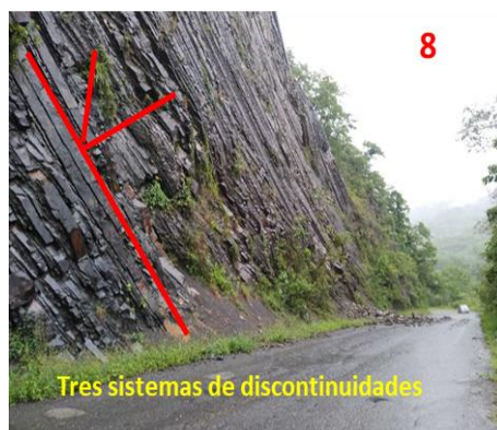
Fotografía 17. El talud presenta alto riesgo por caída de bloques, estos eventos se intensifican en temporada de lluvias.
