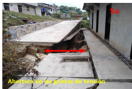
Fotografía 9. Desplazamiento de bloques de hasta 1.5 metros afectando a viviendas.
