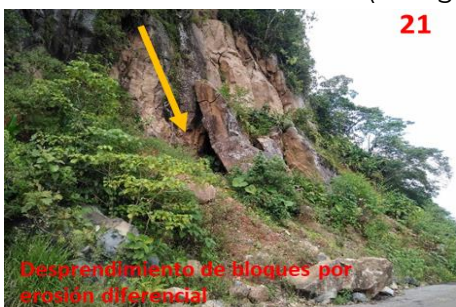
Fotografía 30. Desprendimiento de bloques columnares por erosión diferencial de la toba y la andesita-basalto.
