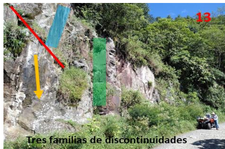
Fotografía 22. Zona de caída de bloques de forma columnar formados por tres planos de discontinuidad, con afectación al camino de terracería.
