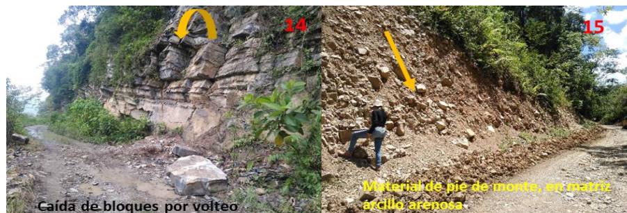
Fotografía 23. Taludes inestables por la presencia de plegamiento y material de pie de monte, en una matriz fracturamiento que genera caída de arcillo-arenosa con acción del agua, se desprenden bloque de roca.
