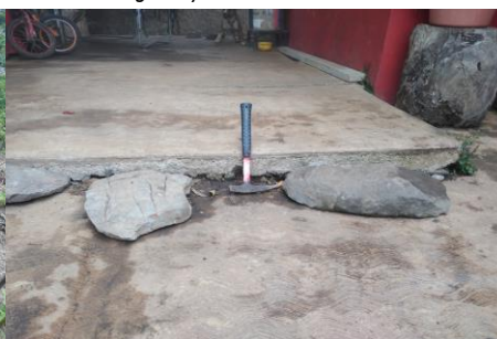
Fotografía 41. Evidencia de hundimiento en el patio de una casa de la localidad de Chachala.
